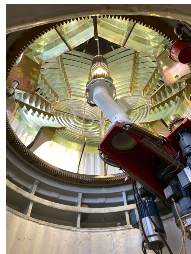
De in november 2023 geplaatste led-armatuur. Foto: Joost Kruitwagen, Tebezo.
