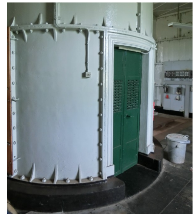
Het interieur van de Lange Jaap. De buitenschacht is hoekig, de binnenschacht rond.
