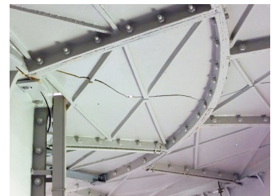
Scheuren in de gietijzeren vloerdelen.
